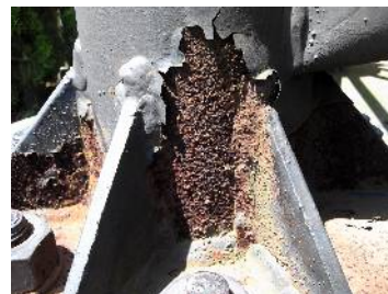
写真② 足元の錆
