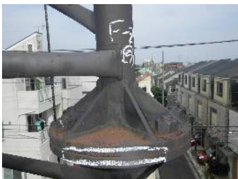
写真① フランジの隙間
